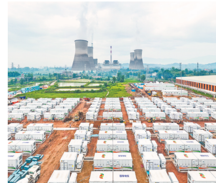
西南地区规模最大的电网侧独立储能项目——合川双槐新型储能电站7月底并网投用
